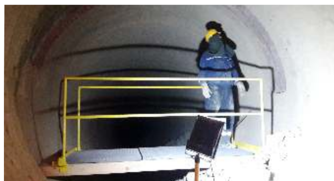
Rad u zatvorenom prostoru: unutrašnjost rotacione peći
